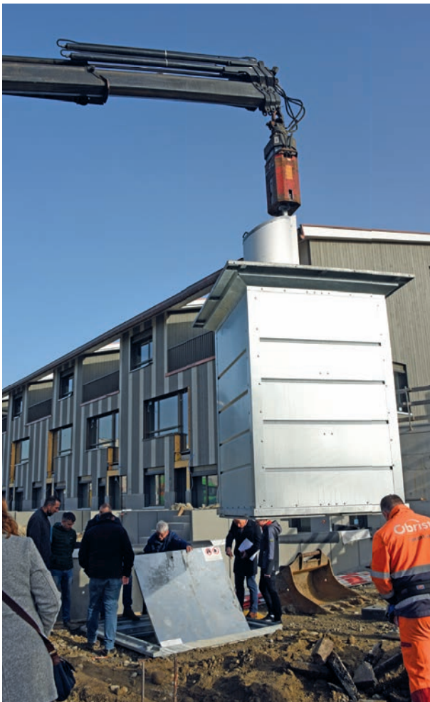
Die Installation neuer UFC-Anlagen ist, wie hier in Mettmenstetten, auch bei Neubauten gut angelaufen.
