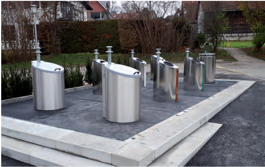
Die UFC-Anlage in Ottenbach
